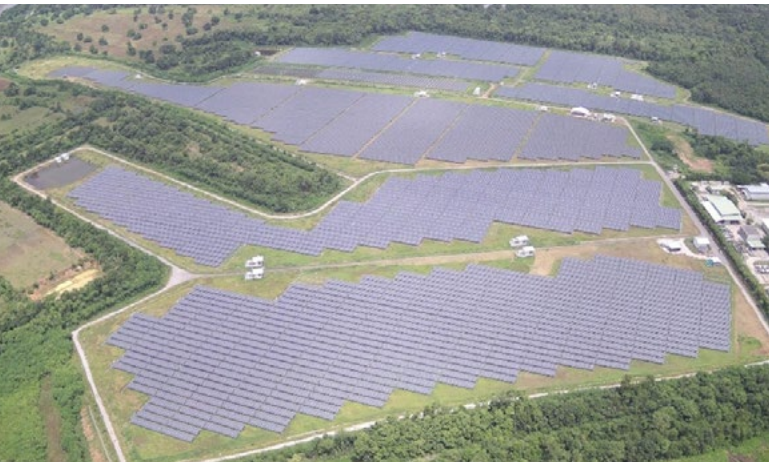
Solar farm at Siam Cement (Kaeng Khoi) Co., Ltd.
